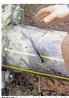
TAGLIO Il danno che ha generato tutto il caos. (Foto Metanord)
